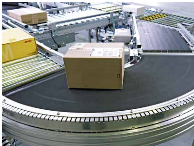
Криволинейный конвейер в распределительном центре
