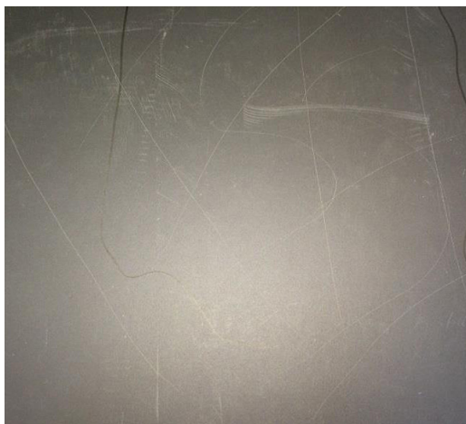
Repor och skador i ytan.
