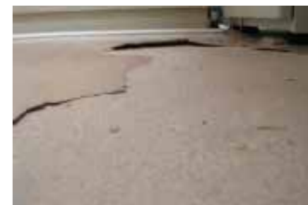
柔らかい下地に施工し破損したマーモリウム
