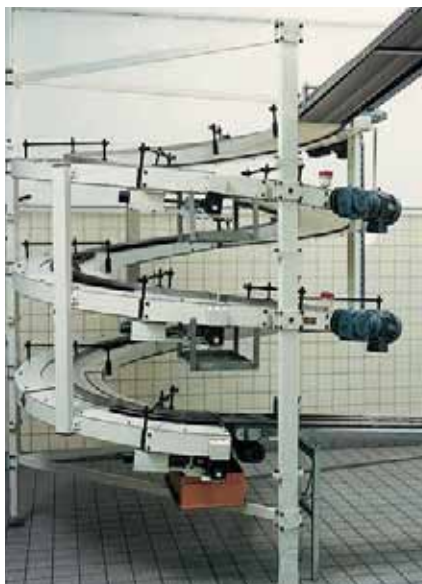
製薬工場のスパイラルコンベア。幾つものカーブコンベアを組み合わせられてつくられるスパイラルコンベアは、効率的な空間利用に欠かせません。
